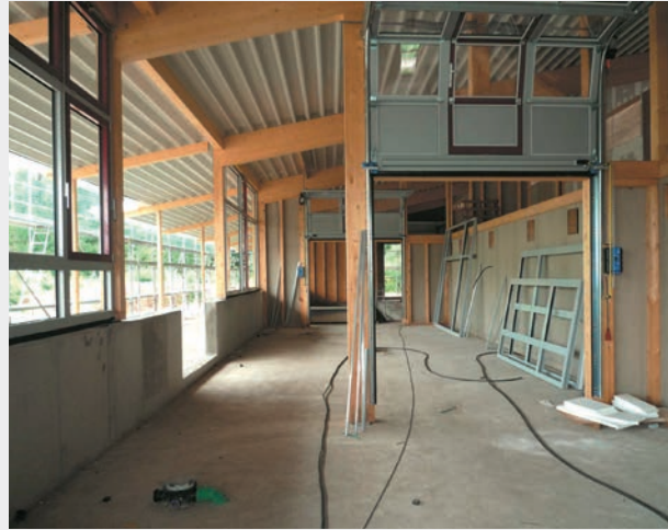
Blick im Rohbau in die drei Praxishallen mit den Rolltoren zur Trennung
